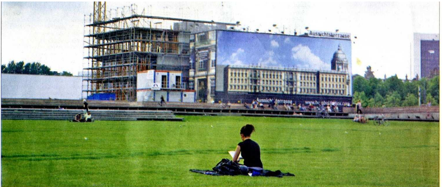
Noch wird am geplanten Informationszentrum Humboldt-Box gearbeitet. Der Bau kostet fünf Millionen Euro
